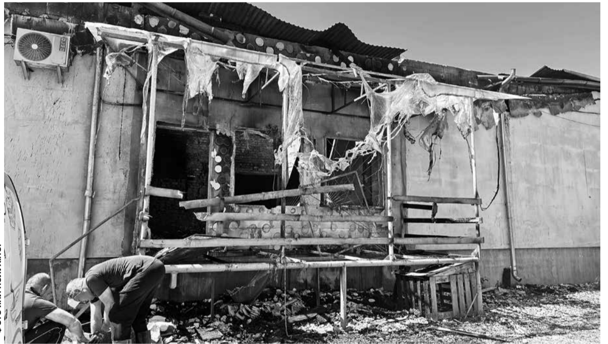
Зруйнований виробничий цех
