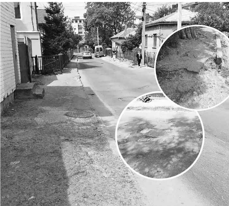
У Тернополі зареєстрували нову петицію щодо ремонту вулиці Зелена. Мешканці скаржаться на пошкоджену дорогу та аварійні тротуари. Щоб звернення розглянули у міськраді, воно має набрати 500 підписів
