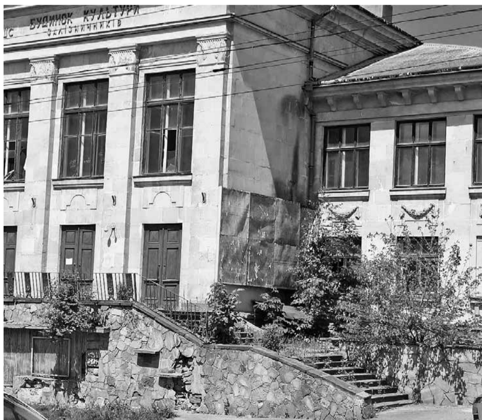
Сходи до Будинку залізничників руйнуються і заросли бур'янами. Кризь бетон вже проросли невеликі деревця
