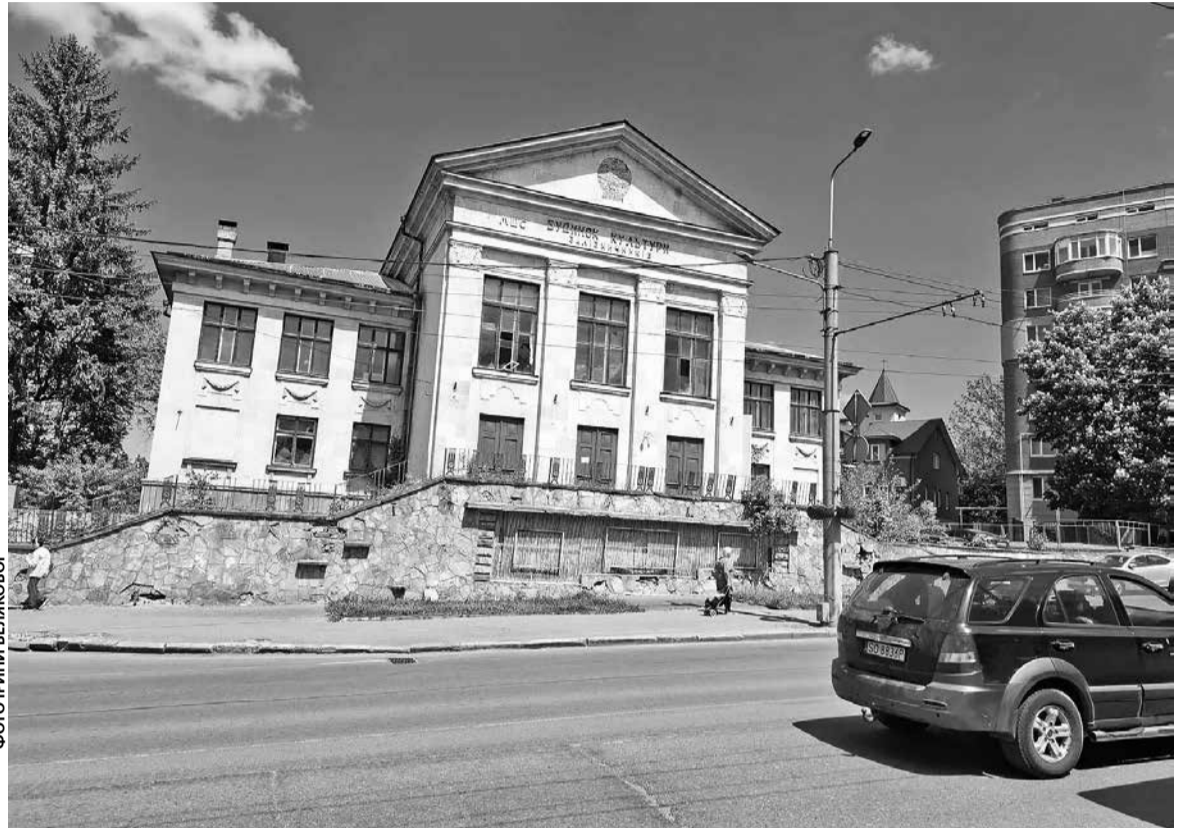
У будівлі вибиті та потріскані вікна, частина рам на другому поверсі звисає вниз
