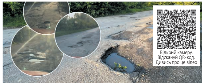
Дорога на Бар через пів року знову у ямах. Пошкодження є і в нових місцях, і на відремонтованих
