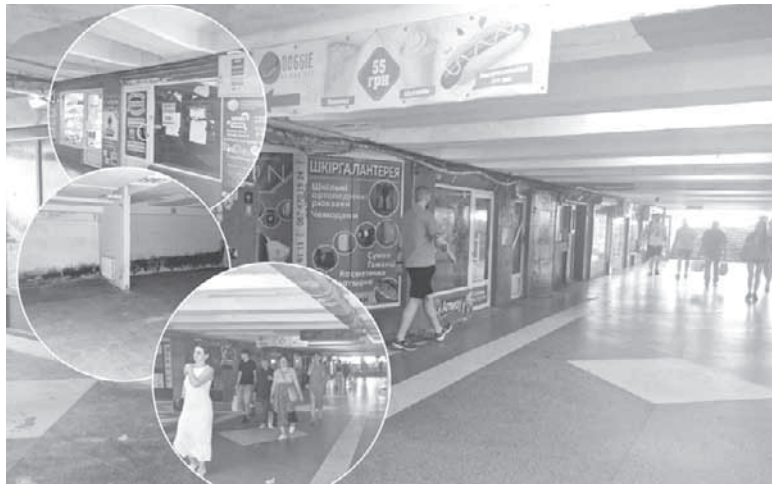
Підземний перехід біля ринку «Урожай» капітального ремонту не бачив із часу відкриття у 2002 році. Конкретних термінів оновлення споруди досі немає
