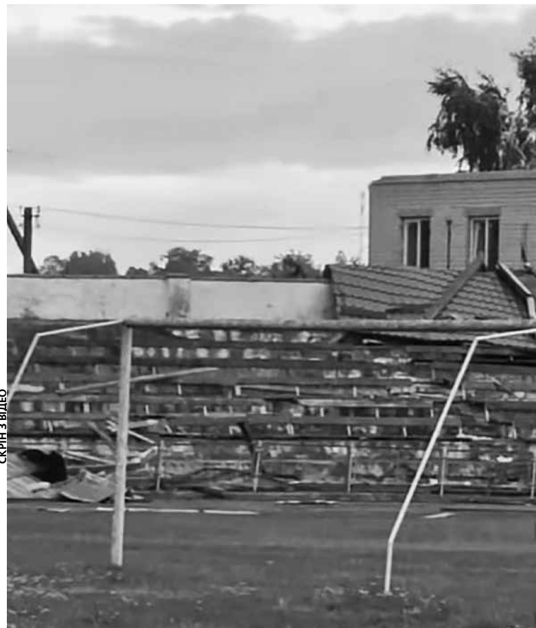
Під час буревію пошкодило весь дах стадіону — його повністю перекриватимуть
