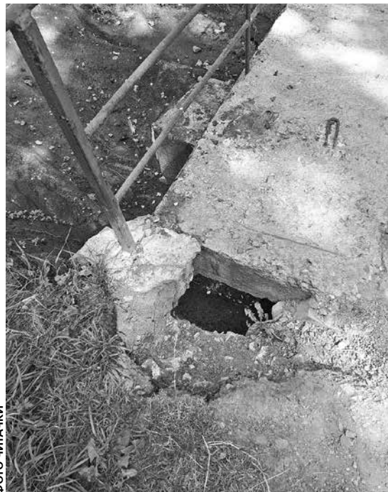
Ось такі дірки вже утворилися в бетонному пішохідному мосту парку
