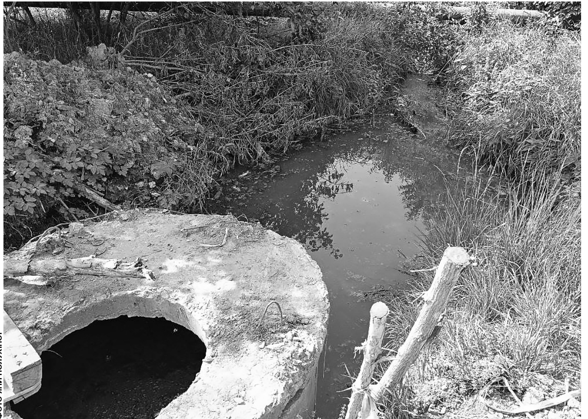
Аварійна ситуація сталася на каналізаційному колекторі, через що частина нечистот витекла і могла потрапити у став неподалік
