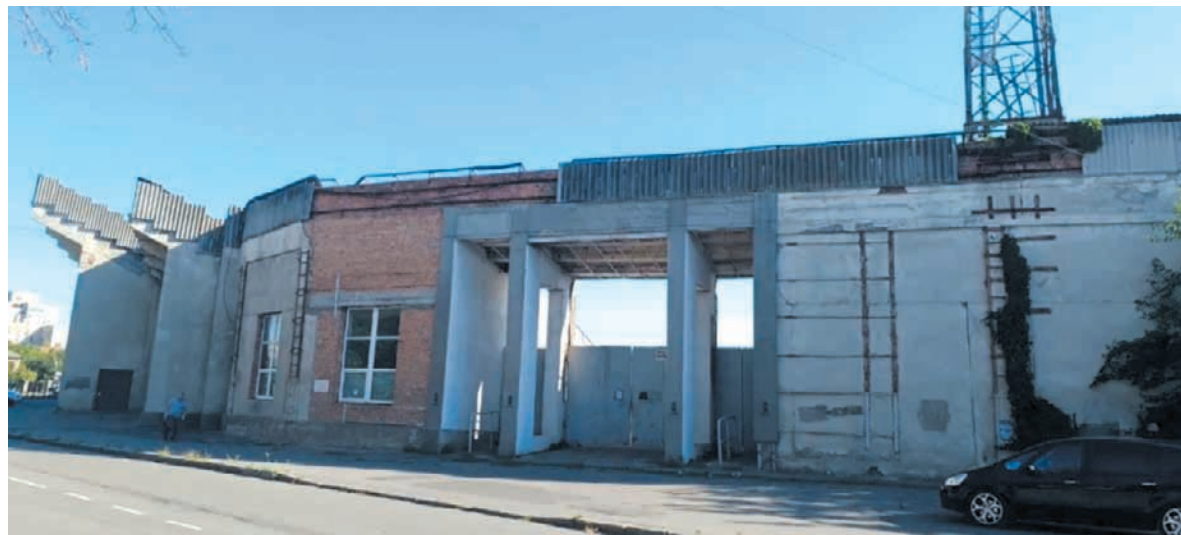
Таким зараз є Центральный міський стадіон на Замостянській. Фасад з боку вулиці Винниченка і вбудовані приміщення чекають на капітальний ремонт
