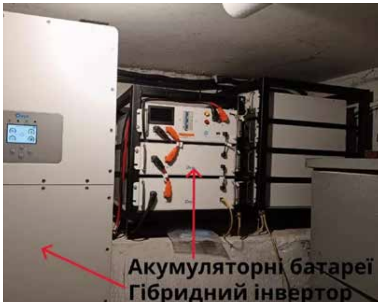
Гібридний інвертор та акумулятори забезпечують будинок електроенергією під час відключень
