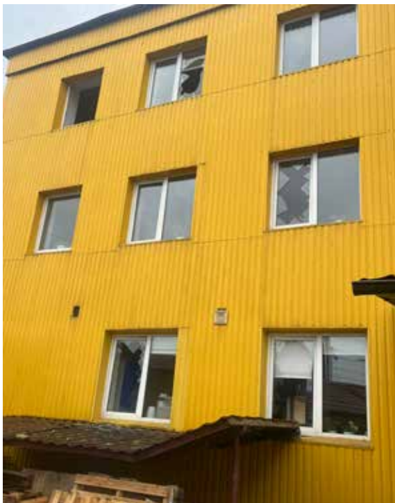
І в адмінбудівлі, і у виробничих приміщеннях вибиті вікна
