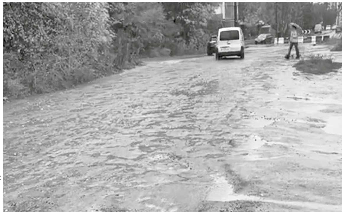
На дорожньому покритті утворилися чималі ями, але поки ремонтувати не планують
